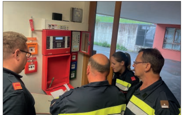
Führungskräfteschulung an der neuen Brandmeldeanlage im Feuerwehrhaus, welche auch perfekt für Übungen genützt werden kann.
